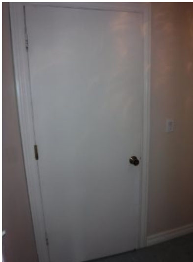
Garage Fire Door
