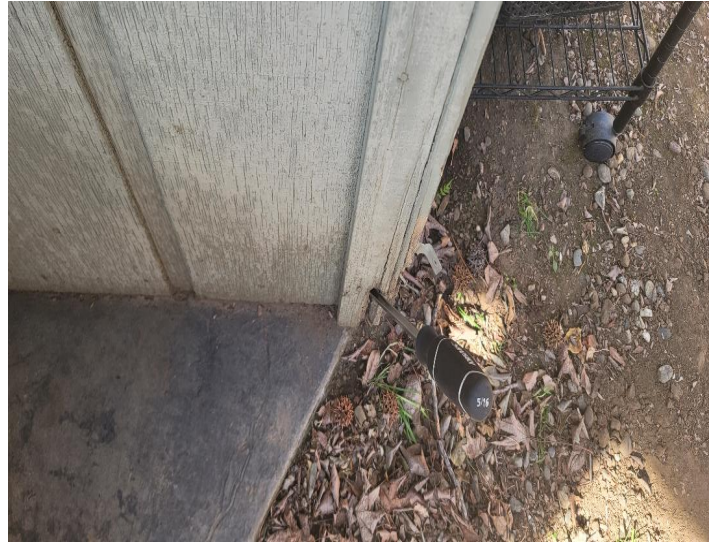
3A - Damaged trim.
