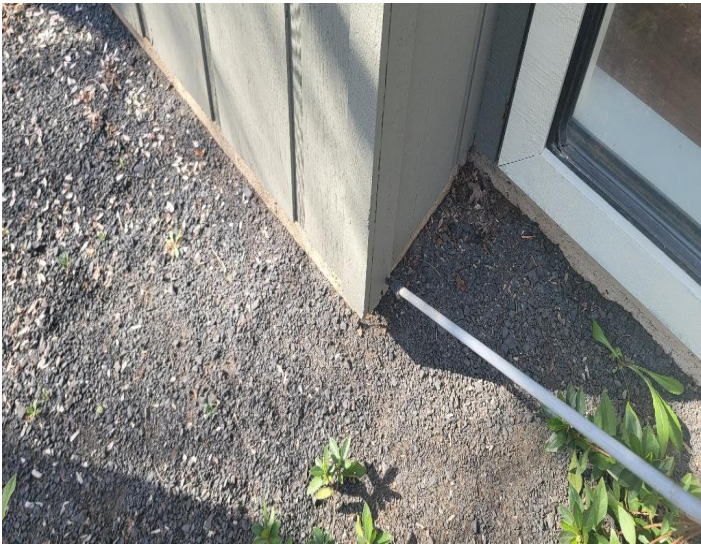
3A - Damaged trim.
