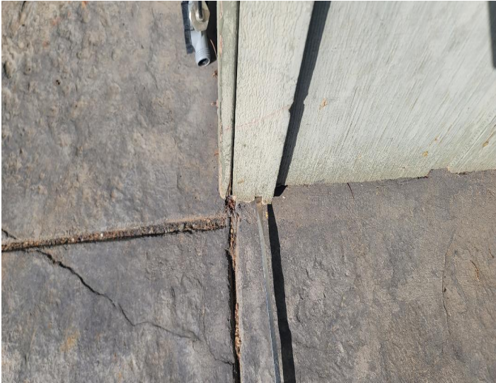
3A - Damaged trim.
