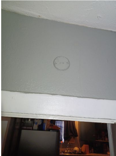
Faltan detectores de humo en áreas (front)
