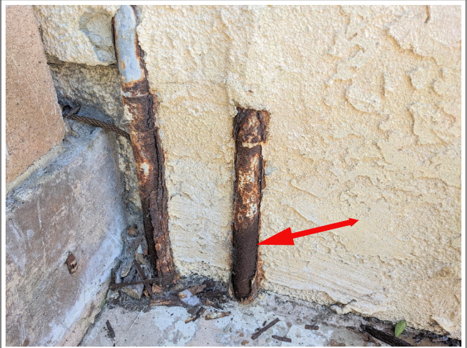
Rust at electrical conduit
