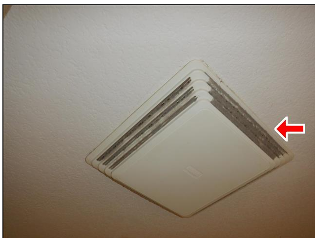
5.8 Item 3(Picture) Dirty fan
