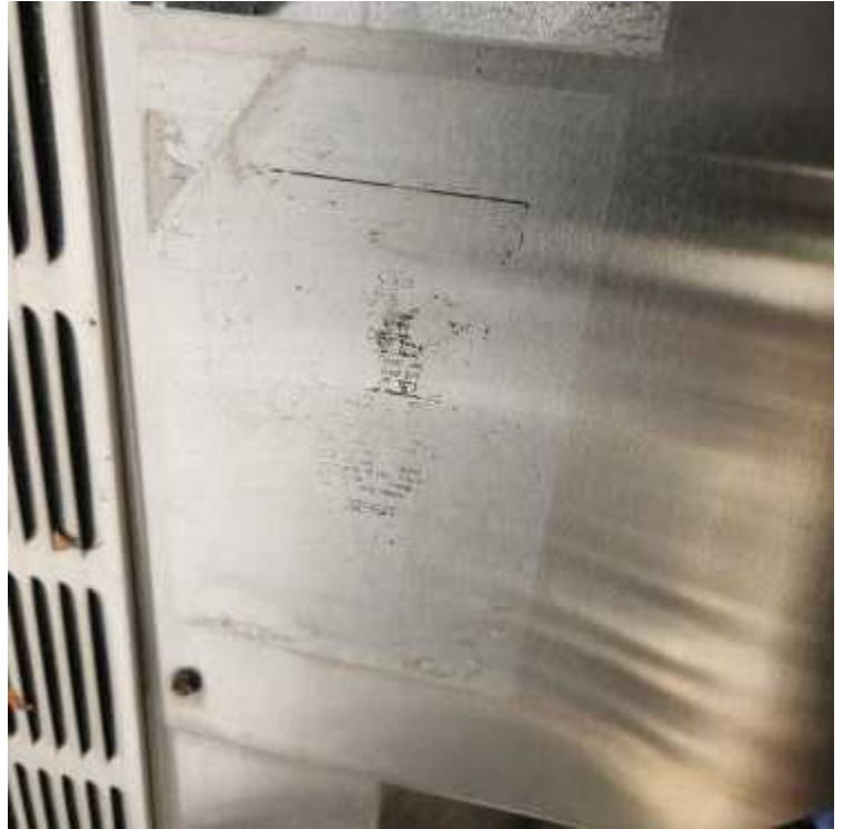
AC Condenser Placard
