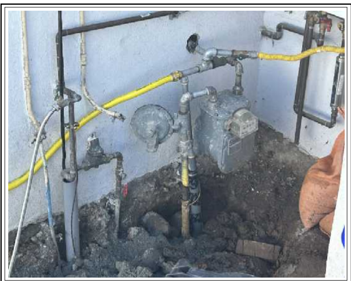
Gas Meter Unit 4128
